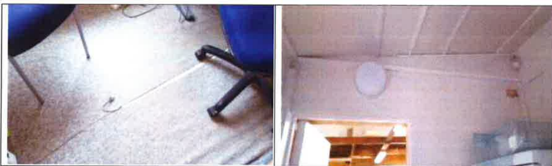
Mynd. Komið er að endurnýjun gólfefna og glugga. Leki hefur skilað sér inn við þvottahús.
