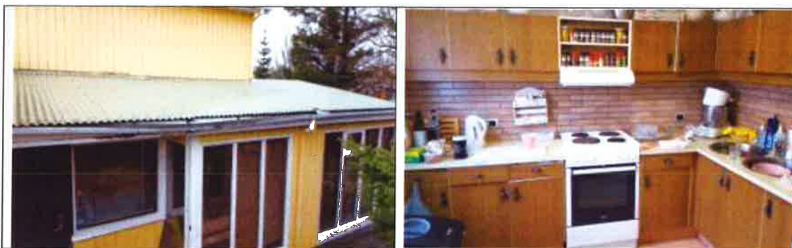
Mynd. Þakjárn þarf að yfirfara sem og rennur. Kominn er tími á að endurnýja eldhúsinnréttingu.
