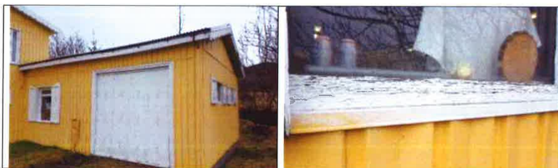
Mynd. Kominn er töluverður fúi í klæðningu og glugga hússins.
